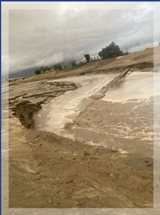
Vista hacia el oeste, Westward Ho Drive en Indio en la parte superior del terraplén, mostrando el canal lleno de agua después de la tormenta.
